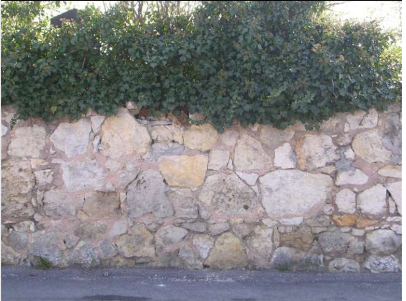
Bild 12: Westmauer (außen) Bsp. für Schaden (Loch)
