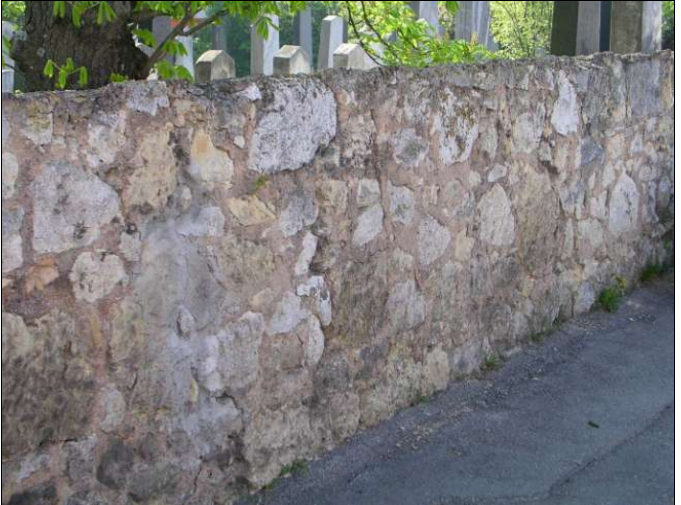
Bild 11: Westmauer (außen) alte und sehr alte Sanierungen
