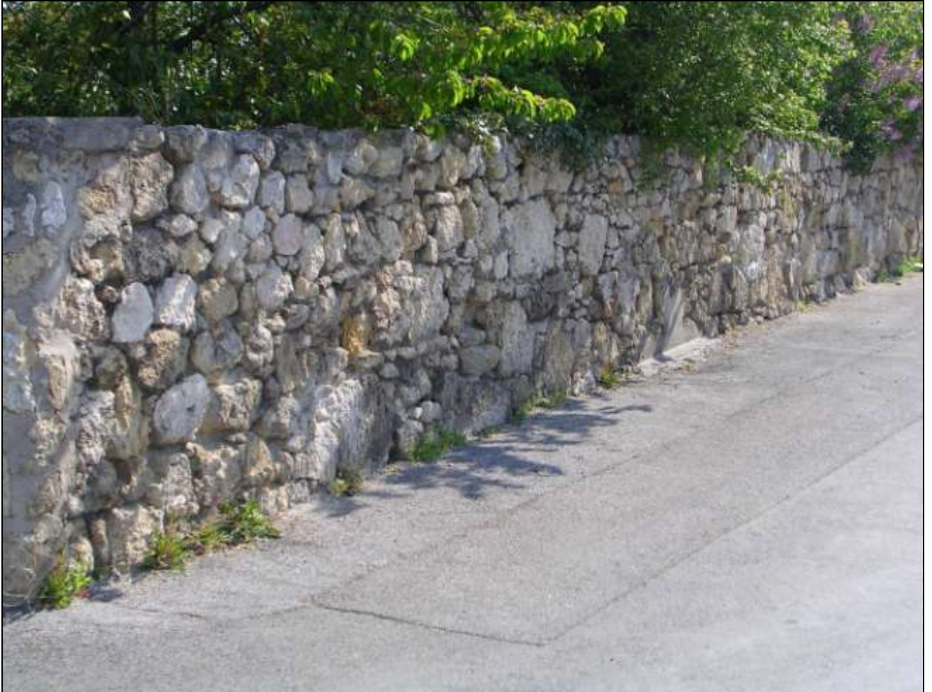
Bild 14: Südmauer (außen): Auswaschungen
